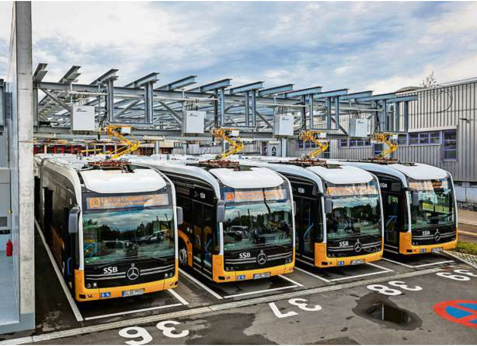
Ungewöhnliche Konstruktion: Die Elektrobusse werden über Stromabnehmer geladen, die ähnlich aussehen wie die der Stadtbahnen. Foto: Lichtgut/Christoph Schmidt
