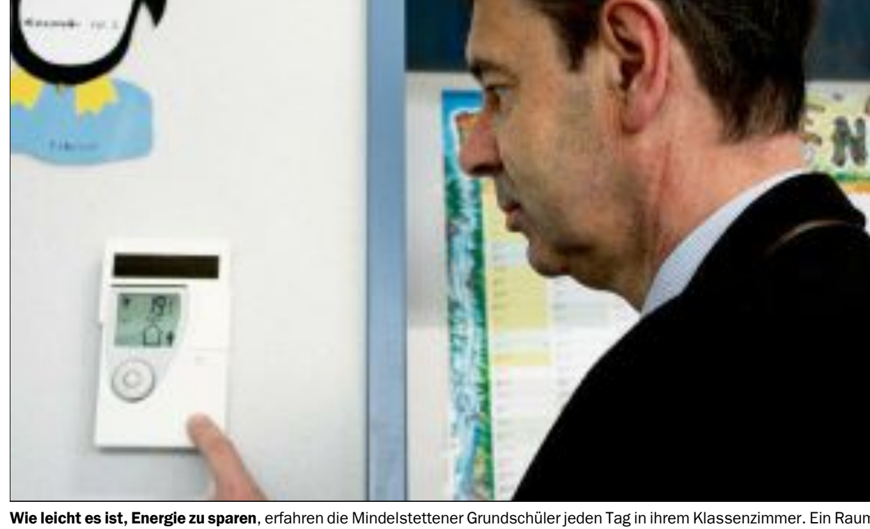
Wie leicht es ist, Energie zu sparen , erfahren die Mindestettener Grundschüler jeden Tag in ihrem Klassenzimmer. Ein Raumthermostat steuert automatisch die Temperatur, wie Bürgermeister Alfred Paulus hier erklärt.
