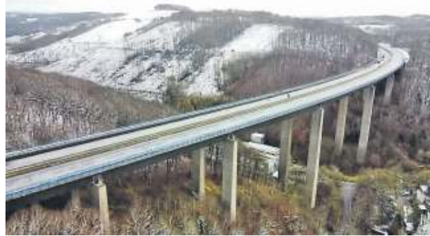
Die Talbrücke Rahmede wird auch für Pkw nicht mehr freigegeben. Sie wird abgerissen. FOTO: DPA
